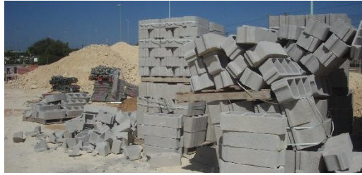
Rotura de material por acopio indebido
